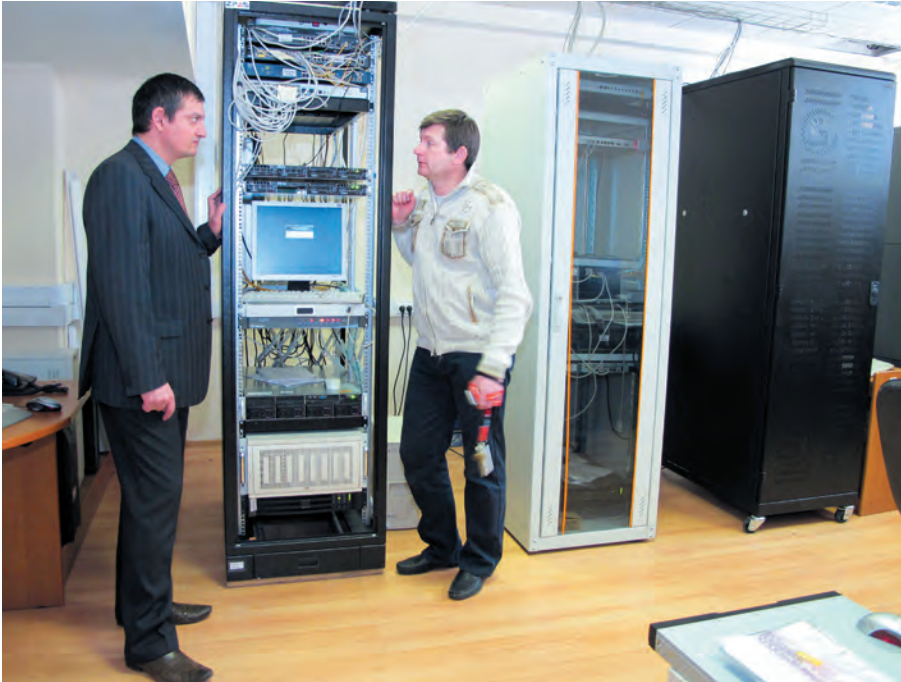
Рис. 4. Серверное оборудование единого хранилища данных ОМС Московской области
