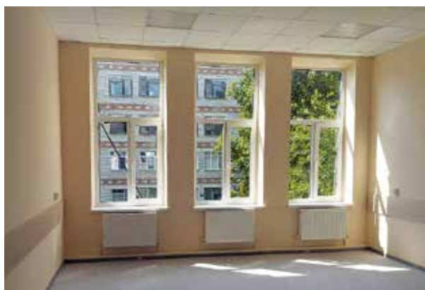
Капитальный ремонт здания поликлиники Абинской ЦРБ провели по программе «Модернизации первичного звена здравоохранения» нацпроекта «Здравоохранение»
